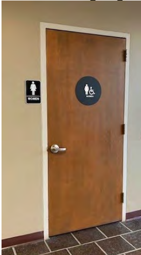
New ADA signage
