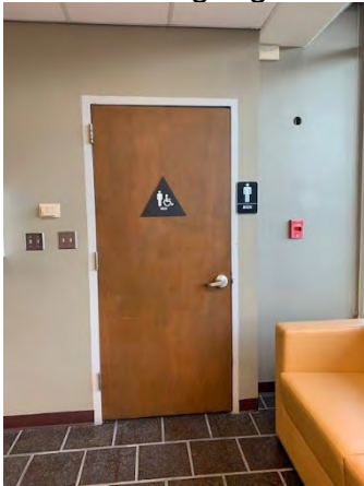
New ADA signage
